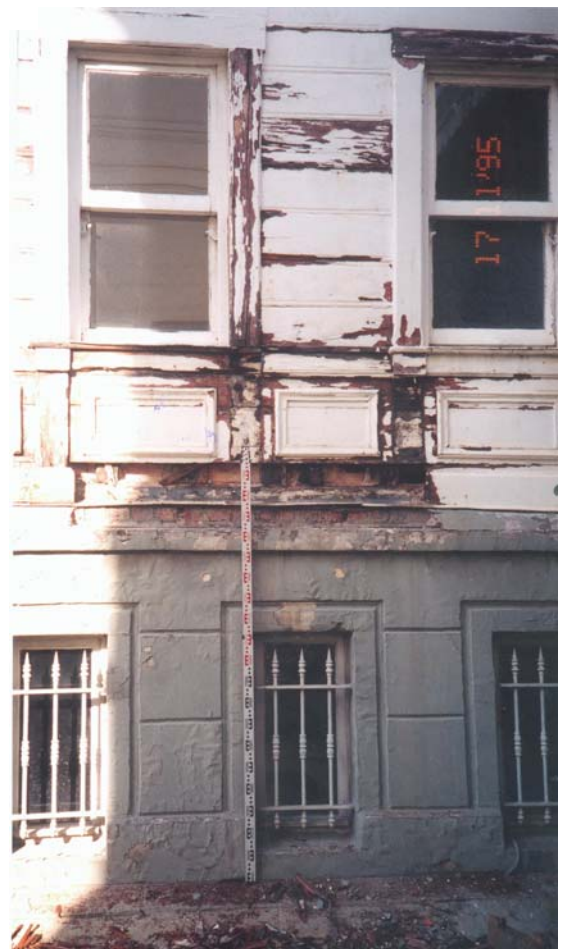
Schäden an den Außenwänden
